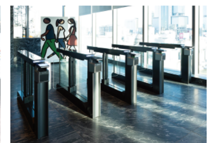
フラッパーゲート
